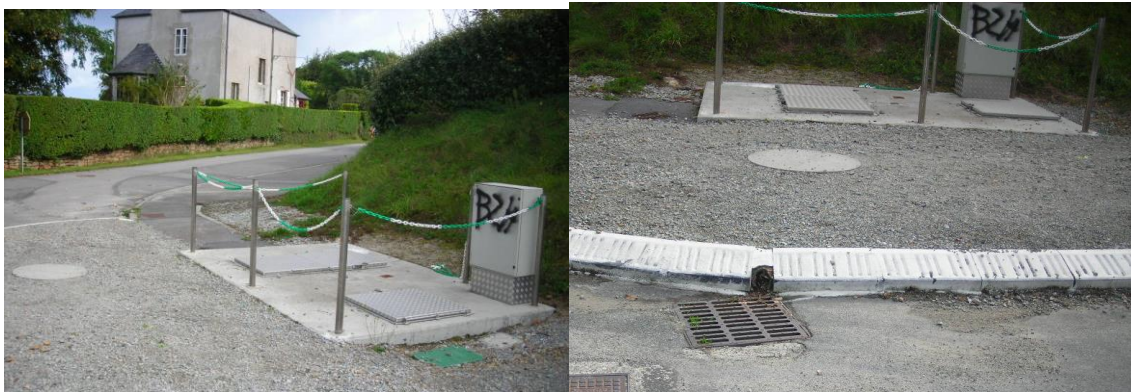
Figure 9 : Poste de refoulement du Château
